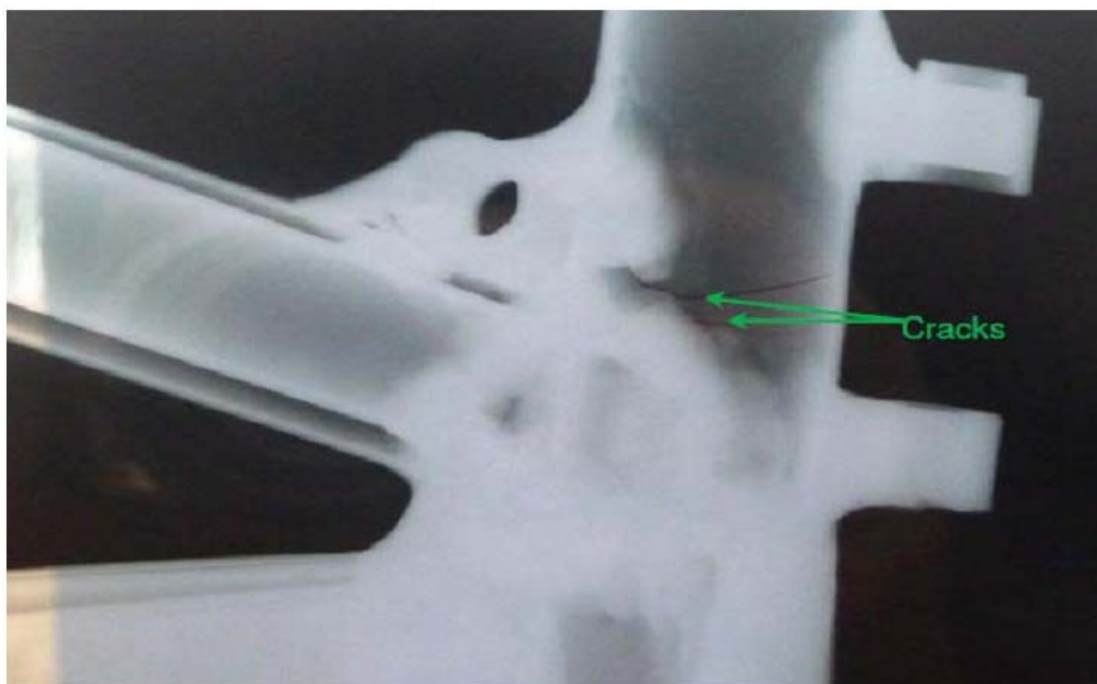
FIGURA 2 – Vista en detalle de rayos X del área dañada en la unión
